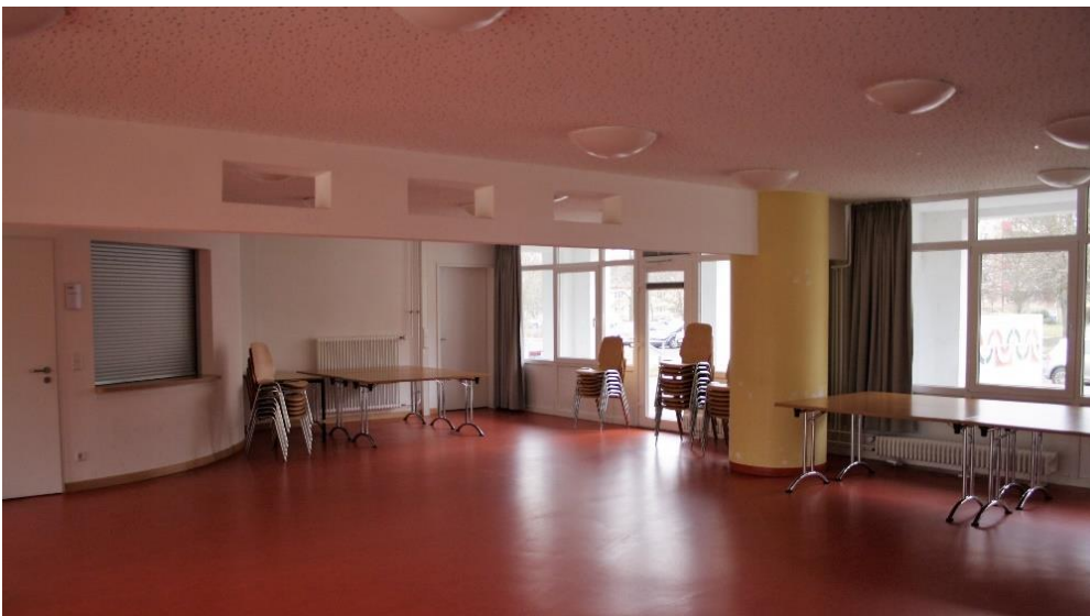
Lärmschutzdecke im Veranstaltungsraum © Planergemeinschaft für Stadt und Raum eG
